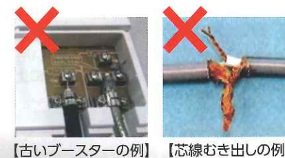
【古いブースターの例】 【芯線むき出しの例】
