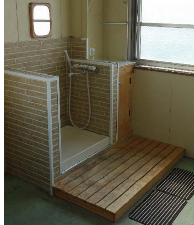
ウドゥ用設備
