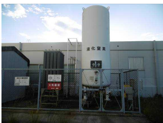
一般高圧ガス製造施設設備
