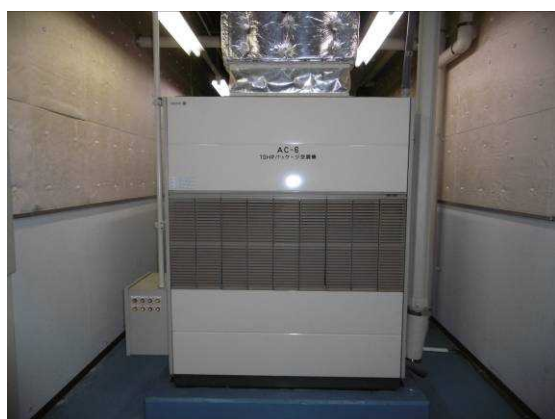
換気空調設備
