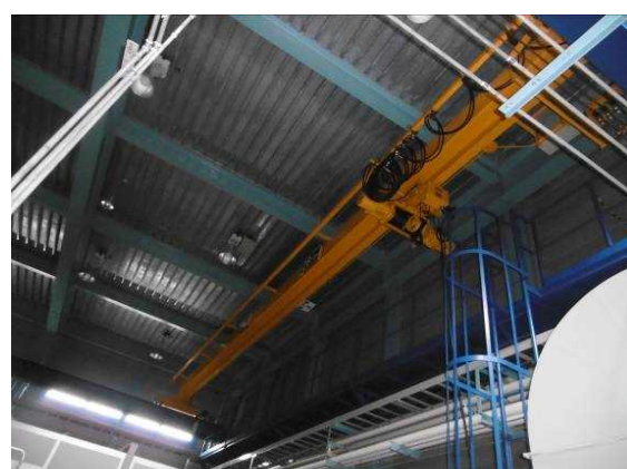
ホイス式天井クレーン設備
