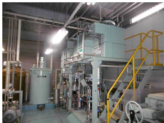
排水処理設備
