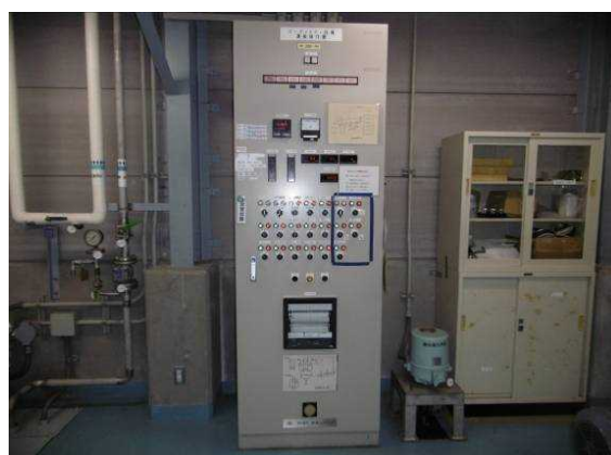
ユーティリティ排水設備
