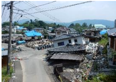
熊本地震で被災した建物(益城町)
