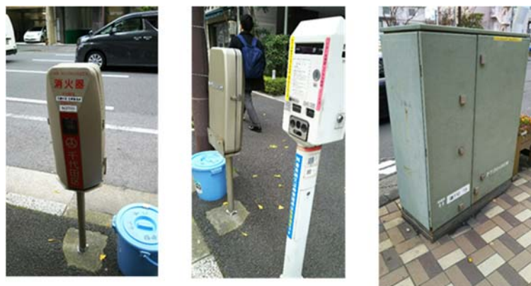
図2-7 一般道に設置されている保守点検が必要な機器のイメージ
