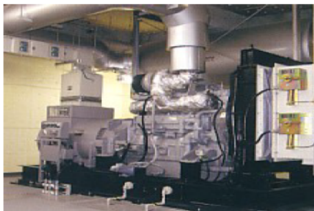
非常用発電機
