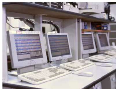
運用監視装置
