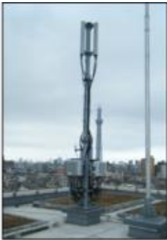
基地局(屋上設置)
