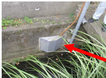
水位センサー設置 （例）
