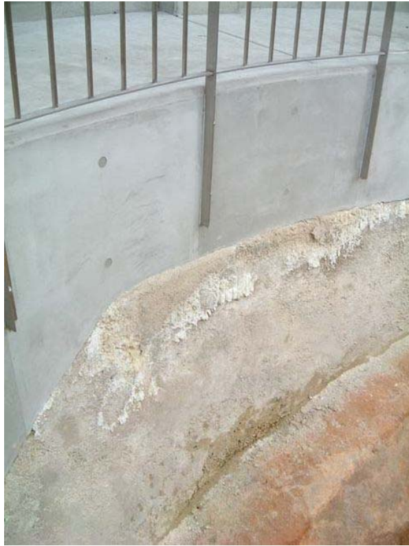
土壤表面に析出した塩類（結晶状の白色物質が隆起）
