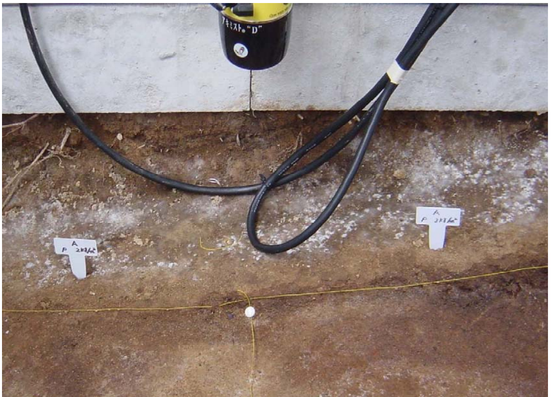
土壤表面に発生したカビ 佐賀県吉野ヶ里遺跡(遺構保存実験施設内)
