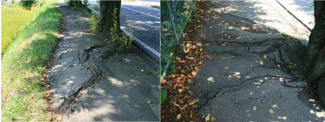
写真 舗装部の根上がり 8)
