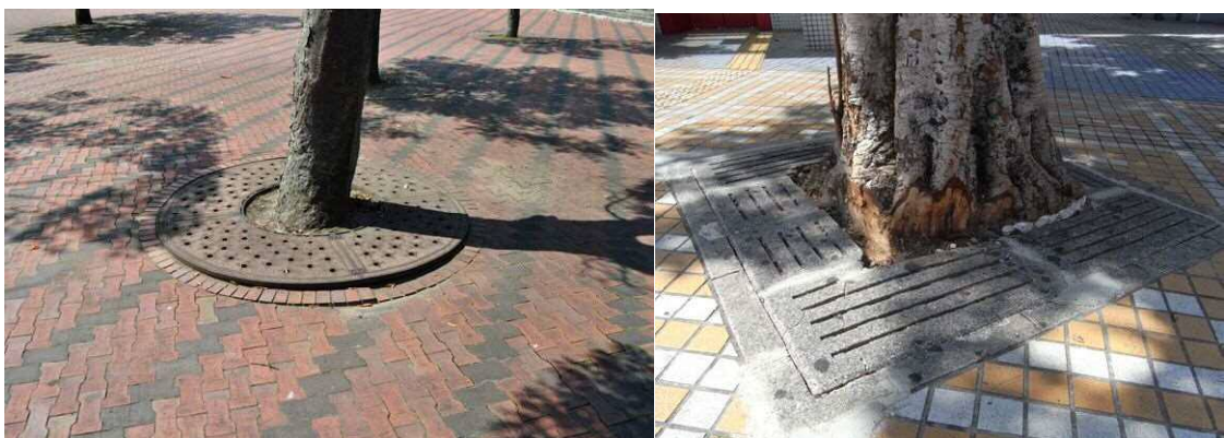
写真 踏圧防止板の不陸 8)
