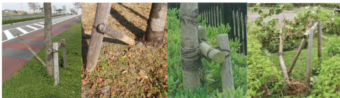
写真 支柱の損傷 3)
