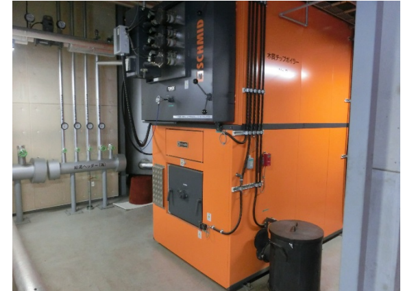
熱を供給しているボイラー
