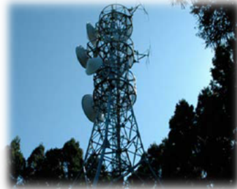
防災行政無線設備の被災
