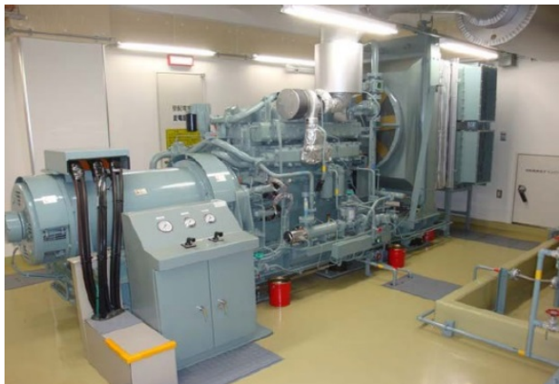
自家発電装置
