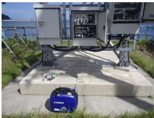
約80局所を携帯発電機でバックアップ
