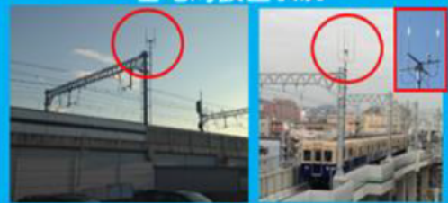
基地局設置状況
