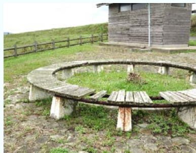
ベンチが破損
