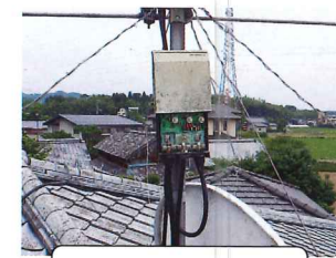
経年劣化したブースター
