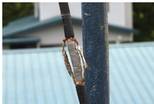
同軸ケーブルの施工不良
