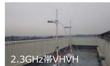
図1 基地局アンテナ
