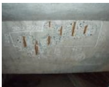
主桁部はく離発生状況
