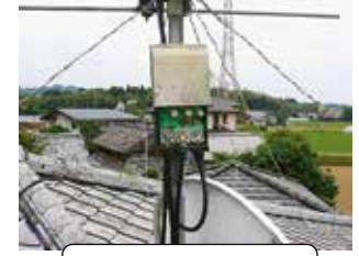
経年劣化したブースター
