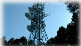
防災行政無線設備の被災
