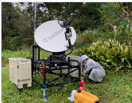
可搬型基地局 118台
