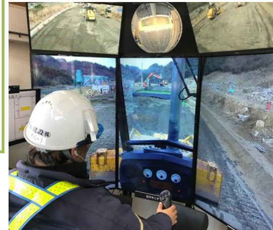
5Gの大容量・低遅延を活かし遠隔施工管理室から重機を操作
