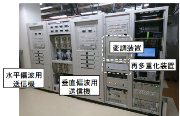
送信機・変調装置・再多重化装置
