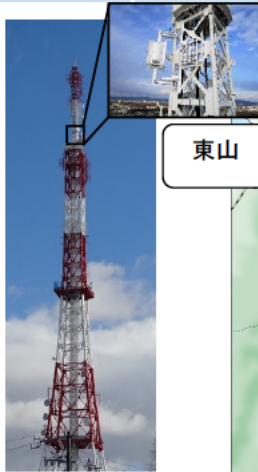
東山実験試験局 送信鉄塔・アンテナ
