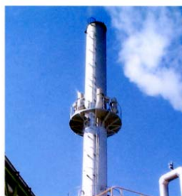
40t/hボイラー
