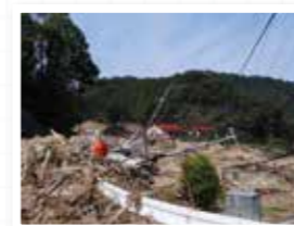
電柱の倒壊・管路の損壊
