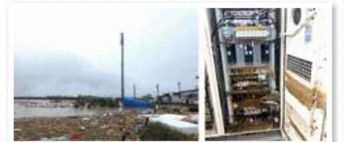
基地局の損壊
