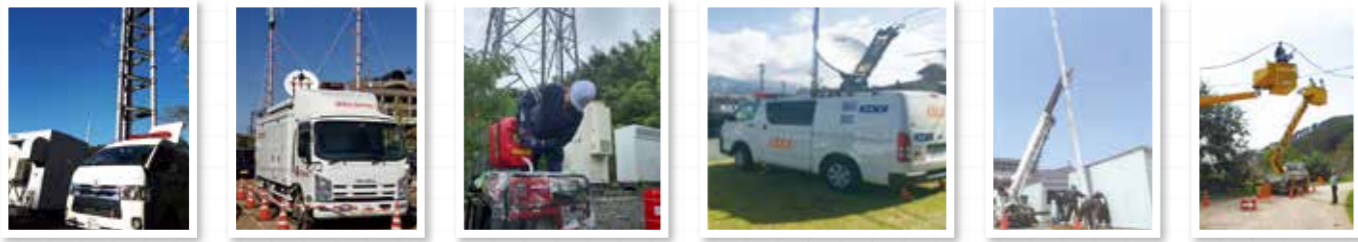
基地局等への移動電源車の派遣 市町村役場等への車載型基地局の派遣 基地局等への可搬型発電機の設置や燃料確保 基地局と通信ビル間を結ぶ、衛星による迂回回線の設置 電柱の建て替え 通信ケーブルの張り替え
