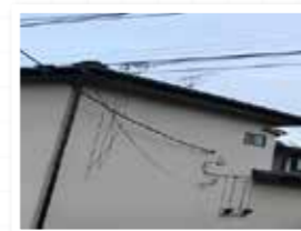
引込線の断線
