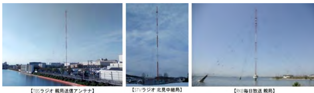
図表 29 AM ラジオ放送の送信設備
