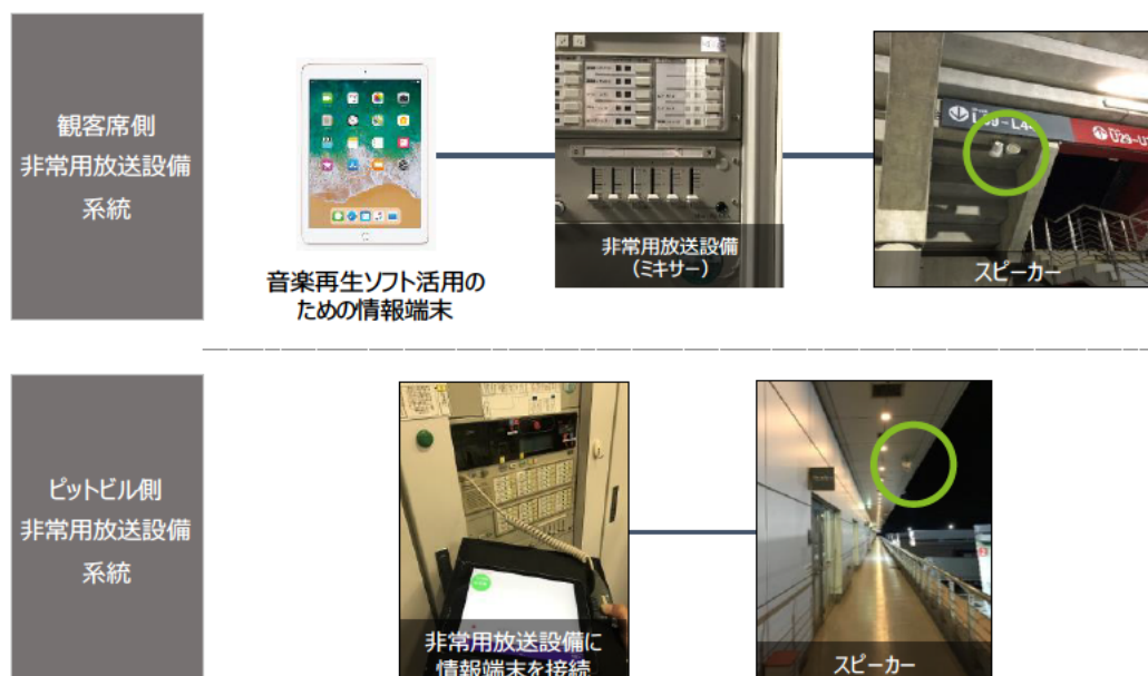
図表 3-56 非常用放送設備のシステム構成（富士スピードウェイ）
