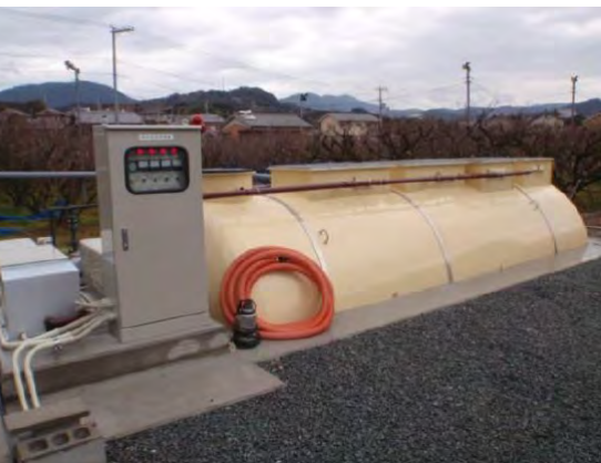
梅加工場の排水処理設備の一例 ／出典：和歌山県工業技術センター提供資料
