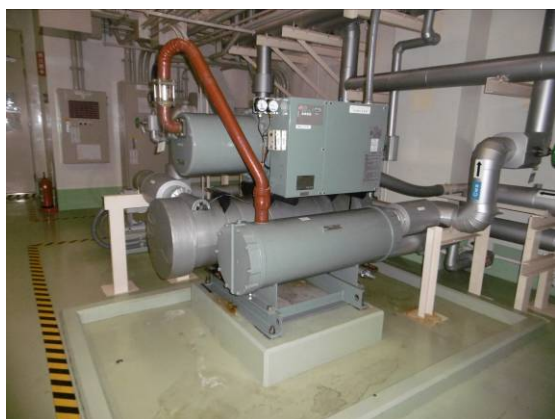
冷水・冷却水設備
