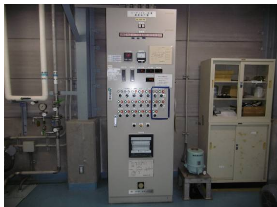
ユーティリティ排水設備
