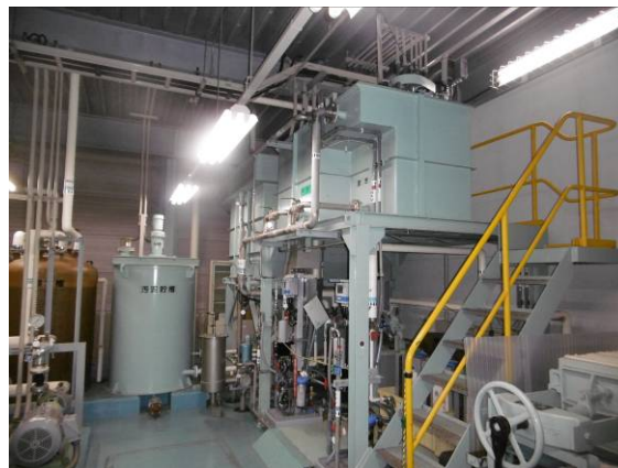
排水処理設備
