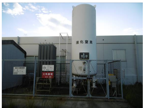
一般高圧ガス製造施設設備
