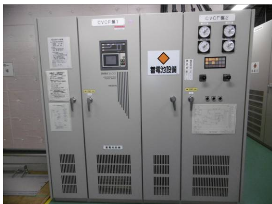
無停電電源装置設備
