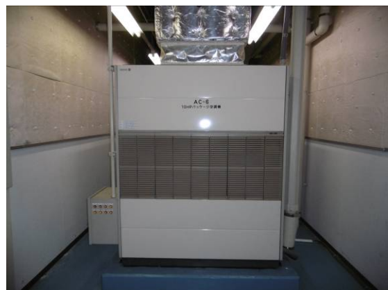
換気空調設備
