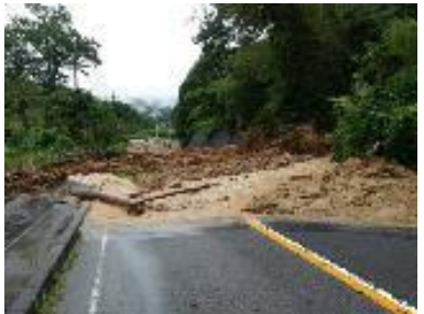
③土砂崩れ発生
