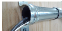
既設配管にて 追張り配線可能
