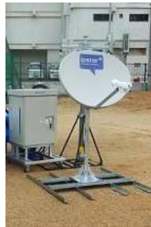
衛星回線設置
