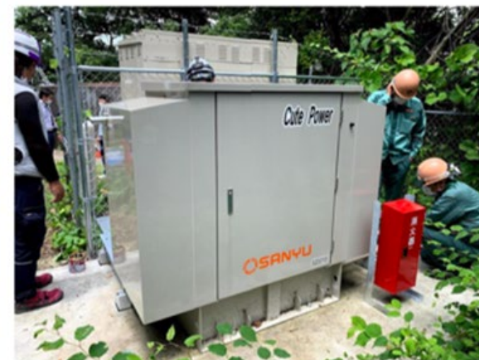
LPガス発電機
