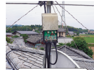
経年劣化したブースター
