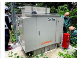
LPガス発電機
