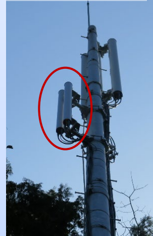
公衆5G基地局アンテナ
