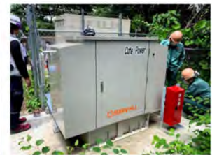
LPガス発電機
