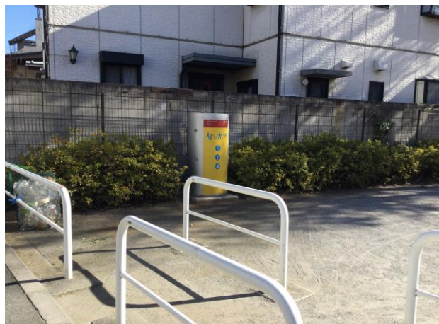
災害用スタンドパイプ
