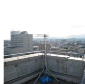
屋上に設置した臨時災害放送局の送信アンテナ
