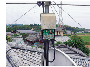
経年劣化したブースター
