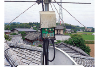
経年劣化したブースター
