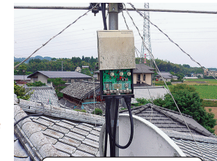
経年劣化したブースター
