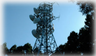
防災行政無線設備の被災
