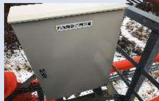
航空障害灯制御盤
