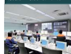
消防・防災システム
