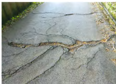
▲木の根が浮き上がり道が凸凹で自転車で通る際に危険！
