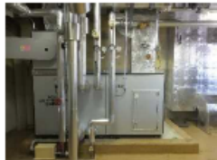
写真1: 研究所生物工学研究棟内に設置されている空調設備
