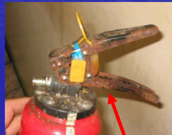
製造後約14年経過の小型船舶用粉末消火器、取手部分が錆びで腐食
