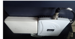
船内壁面に不法中継装置が 設置されている様子
