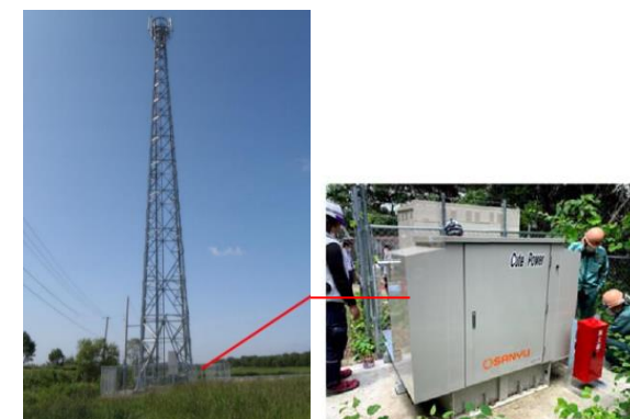
重要エリア基地局の停電対策
